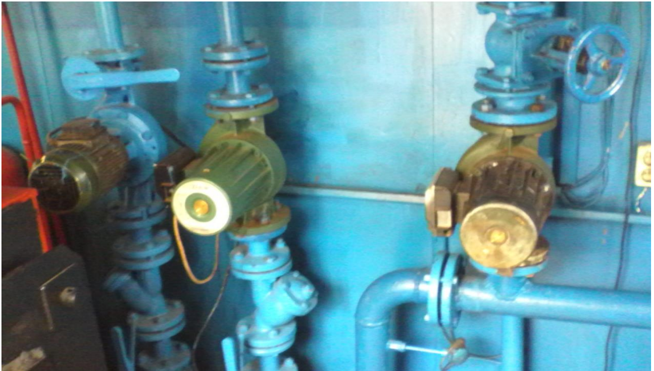
Рисунок 3.3. – Внешний вид насосной группы котельной
