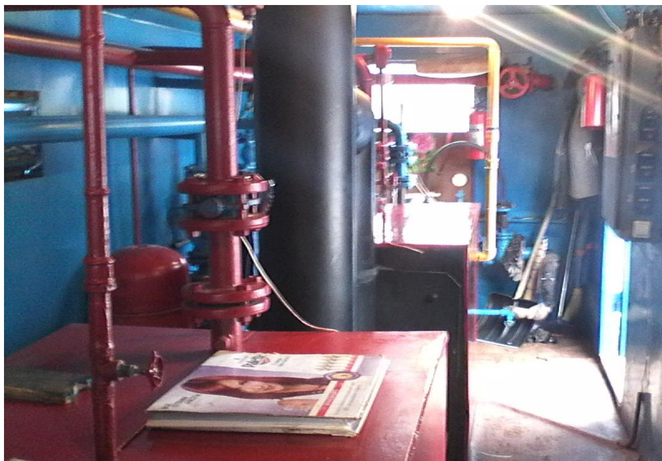
Рисунок 3.2. – Внешний вид котлоагрегатов котельной
