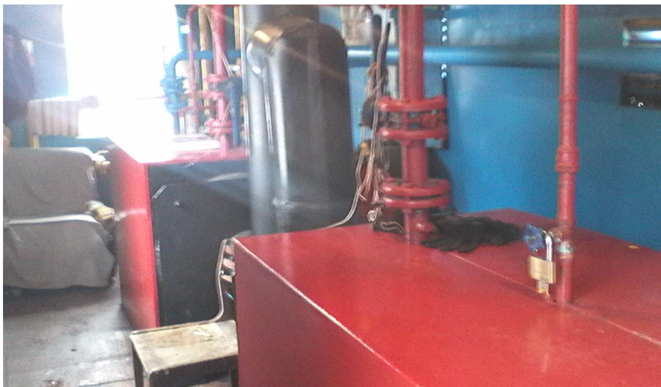
Рисунок 3.1. – Внешний вид котлоагрегатов котельной
